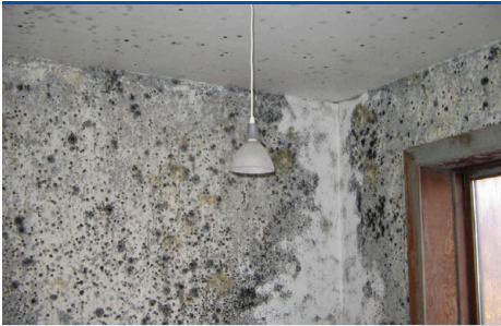
Skimmelvækst i opholdsstue efter vandskade. (Foto: Prottox/kundefoto)
