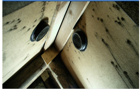
Sortskimmel på undertag pga. manglende ventilation af tagrum (ventiler eftermonteret). (Foto: Prottox)
