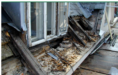
Almindelig råd - tagfod nedbrudt. (Foto: Tryg Forsikring)
