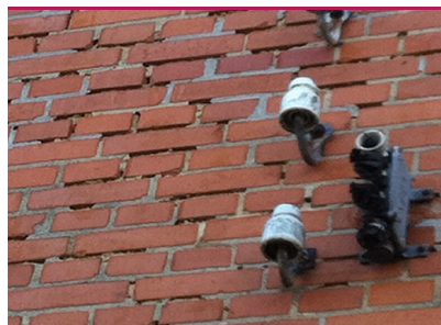
Murbi - ødelagte fuger i muret gavl. (Foto: Prottox)
