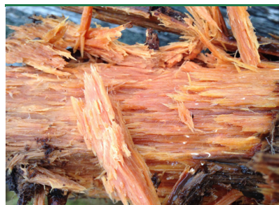
Mastesvamp - Nedbrudt træ. (Foto: Prottox)
