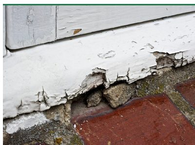
Gråmuld (Overfladeråd) - drypnæse på gammelt vindue.
