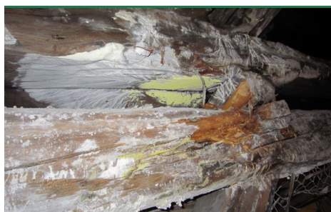
Hvid Tømmersvamp - angreb i tagkonstruktion. Kalkagtige fruglegemer, ungt, hvidt mycelium og bøjelige strenge. (Foto: Bøgh & Helstrup)
