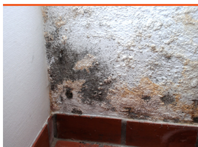
Skimmelangreb i kælderrum
