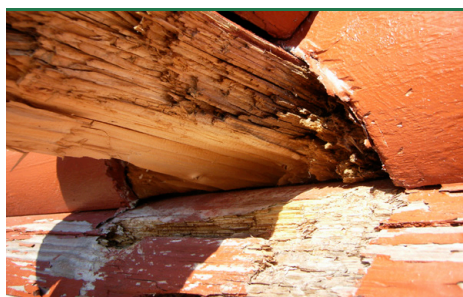
Korkhat - nedbrydning i bjælkehus. (Foto: Protox)
