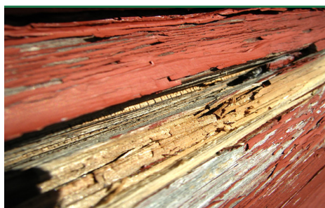
Korkhat - bladet nedbrydning i bjælkehus. (Foto: Protox)
