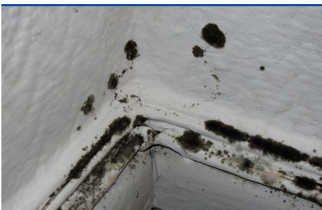
Sortskimmel på fodliste - mangelfuld udluftning. (Foto: Prottox)
