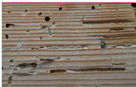
in 16 Alm. Borebille i gulvbræt - flyvehuller og larvegange frilagt på grund af afhøvling. (Foto: Protox)
